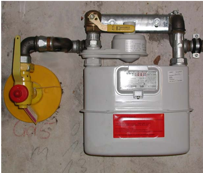
Einzelspartenanschluss mit Gaszähler und Zählerregler
